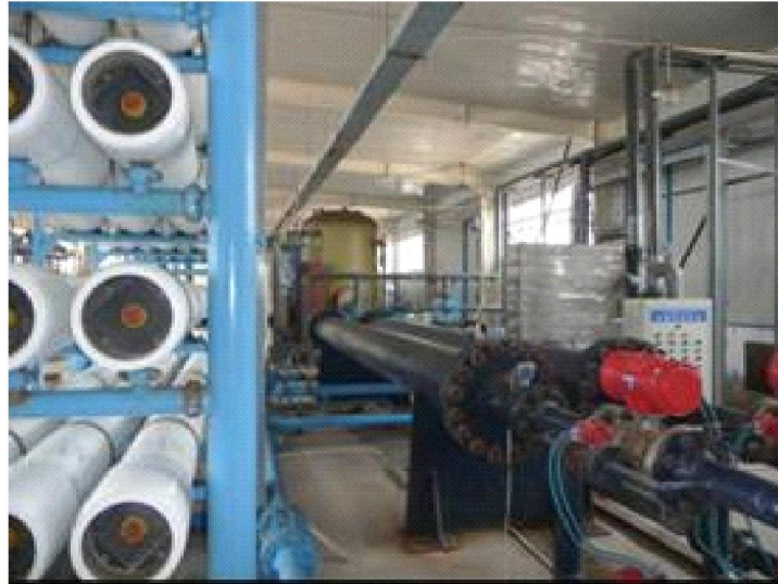
图 1.12.1 天津塘沽 1000 m 3 /d 反渗透海水淡化能量回收装置示范现场
