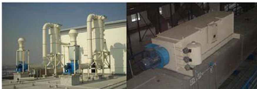
图 6-16 除尘系统配套的除尘器
